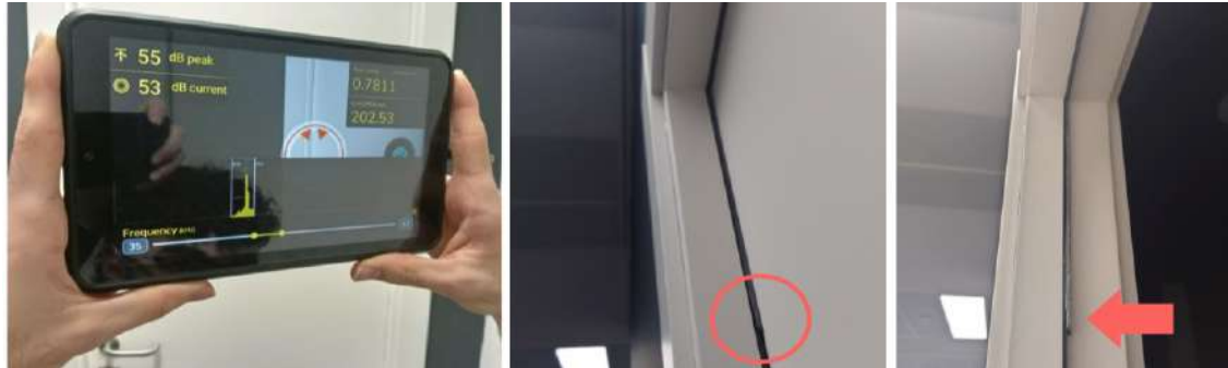
Figura 3. Detección visual de la señal de 40kHz, mostrándose el pico de frecuencia en la cámara acústica (izq.). La filtración de sonido detectada se debe a un resalte de la junta de goma pre-existente, que genera una discontinuidad que impide el cierre hermético de la puerta del Protocolo 2. Fuente: Elaboración propia.
